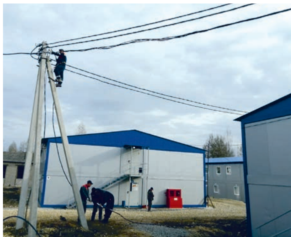
Электроснабжение строительного городка СУ-911 строителей автодороги М-12
